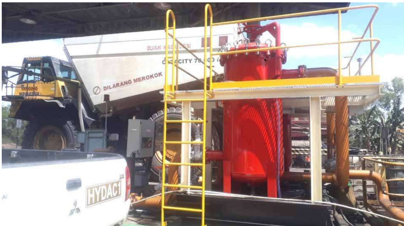
Instalasi filter biodiesel Hydac untuk Fuel Dispensing Station setelah Main Tank
